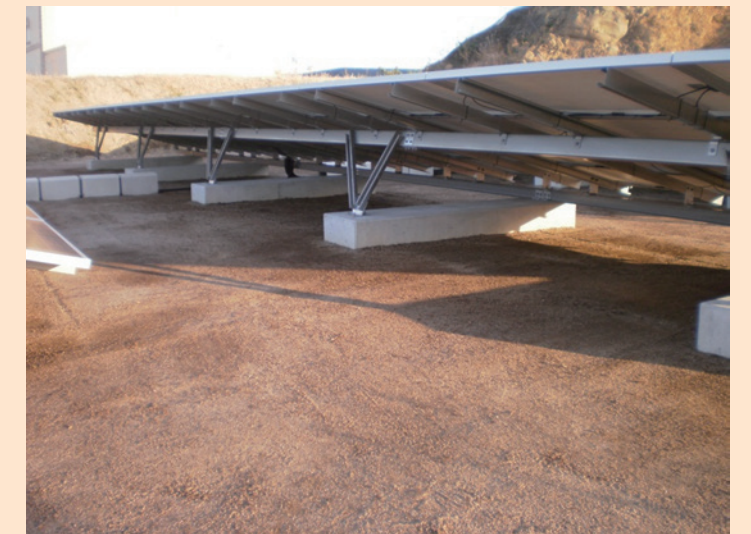
福岡県福岡市太陽光基盤② (撮影日 H24.12.11)
